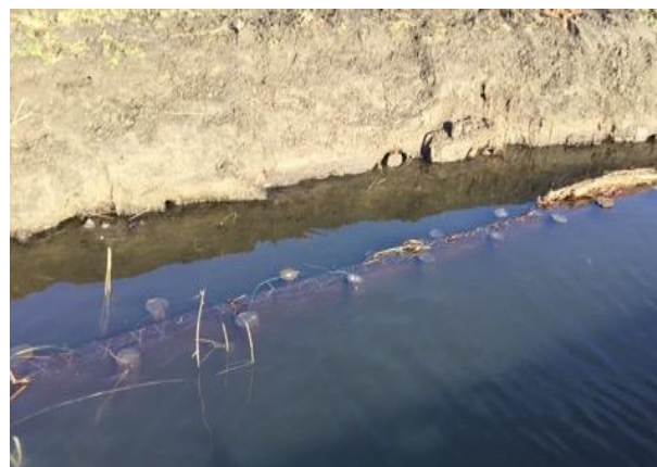
Paaltjes met wiepen staan onder water.
